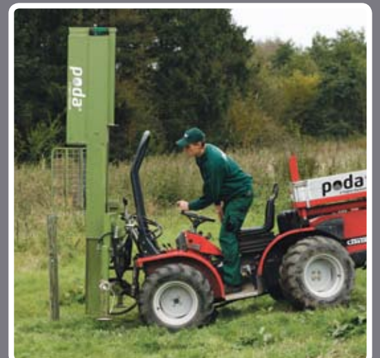
Den lille, vævre "Carraro" maskine kommer hurtigt omkring med sin kraftige pælehammer - uden at efterlade sig dybe hjulspor.
