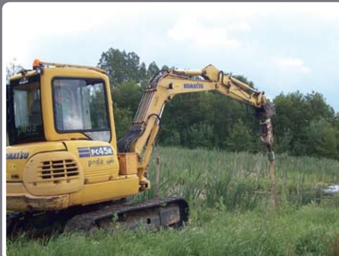
Denne maskine sparer virkelig tid. Pælehammeren er monteret på den lange arm, som kan række over forhindringer. Larvefodder gør det muligt at komme frem i sumpet terræn.
